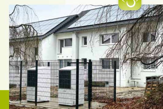
Sanierte Häuser Griegweg mit Photovoltaik-Anlage und Wärmepumpen
